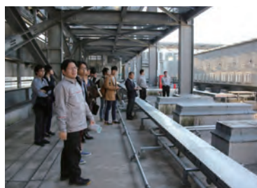
BCP対策見学会の様子：屋上に設置された非常用電源設備を見学
